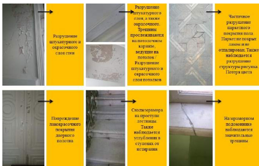
Рис. 2. Ведомость дефектов интерьера усадьбы А.И. Губина.
